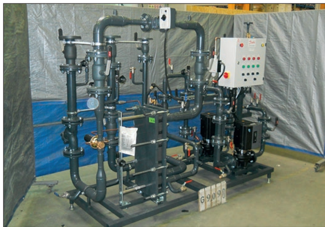
Рис. 44. Автоматизированный тепловой пункт.
